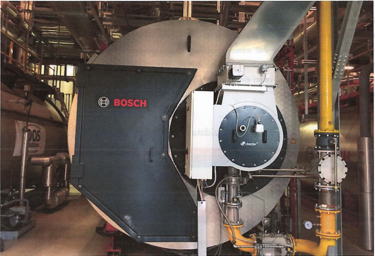
Figura 2 - Caldaia Ausiliaria a Vapore
