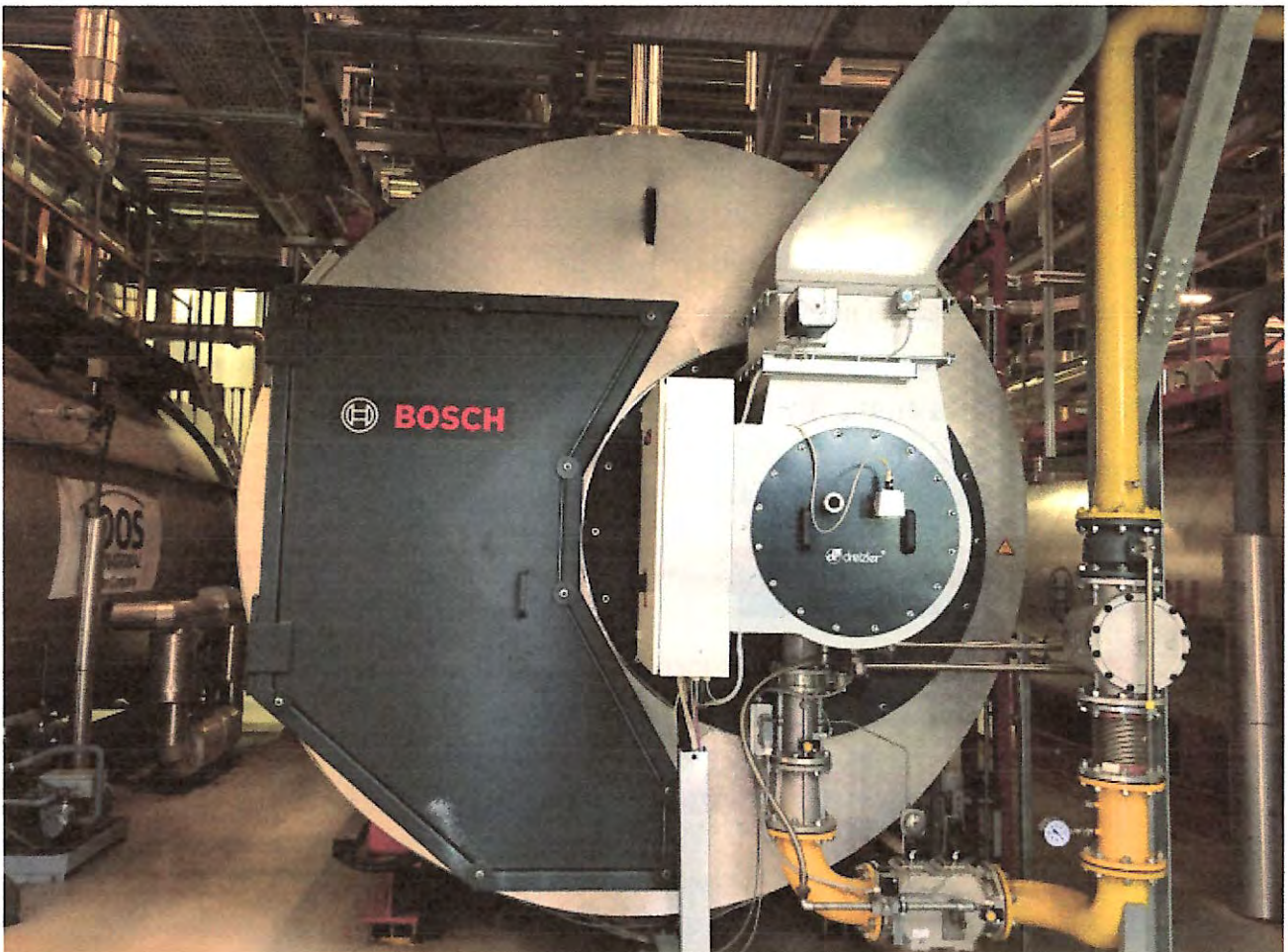
Figura 3 - Caldaia Ausiliaria a Vapore
